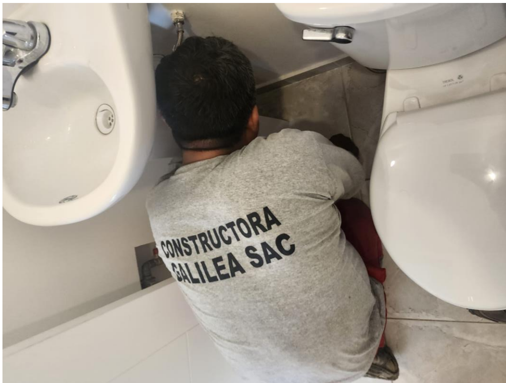
Ilustración 1 Inspección técnica de lavatorio
