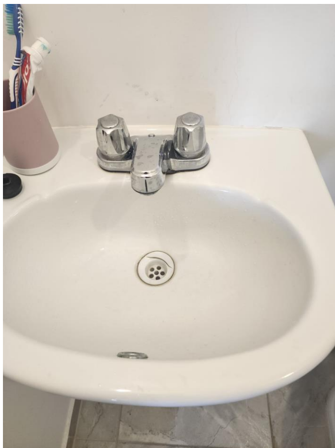
Ilustración 2 Trampa de lavatorio rota
