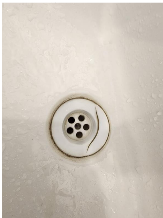
Ilustración 3 Trampa de lavatorio rot
